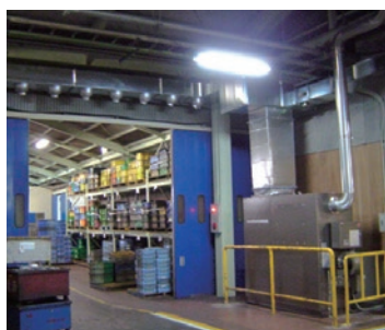
工場 エアカーテン
